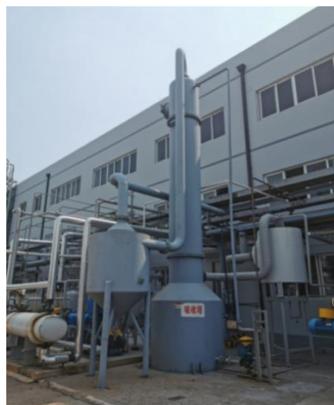
车间水喷淋吸收塔
