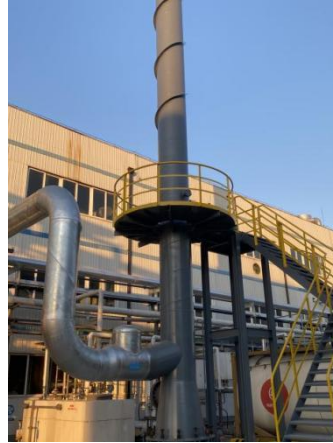
包装废气排气筒
