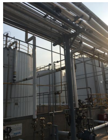
罐区废气收集装置
